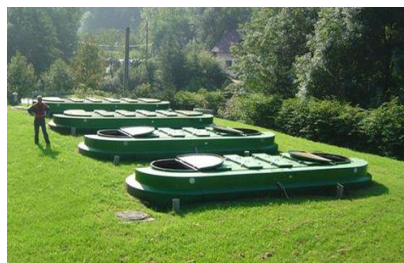
Slika 5: čistilna naprava v Lovrencu na Pohorju
